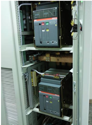
Slika 4. Prekidači QP i QK u ormaru naizmjeničnih dovoda
