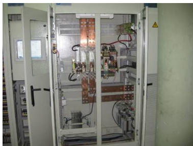
Slika 6. Prekidač i otpornik za demagnetizaciju generatora G1
