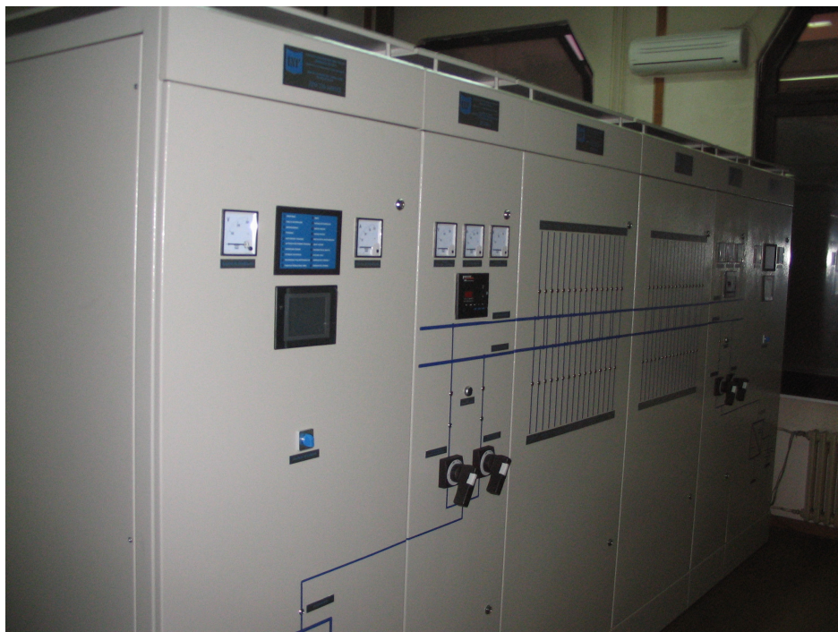
Slika 2. Izgled ispravljača DRI 220-160PTD i razvoda jednosmerne struje
