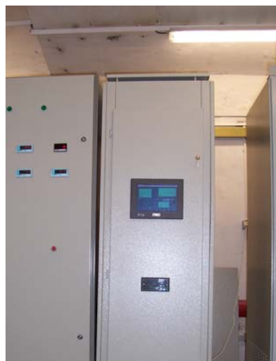
Sl.8. Centralna nadzorna jedinica (CNJ)
