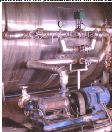
Slika 7 - Pumpa 55kW sa regulacionim ventilom
