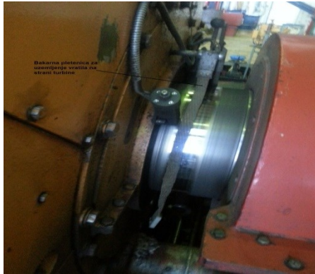
Slika 8. Bakarna pletenica za uzemljenje vratila na strani turbine
