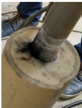
Slika 4. Izgled kablovske završnice u fazi „5“
