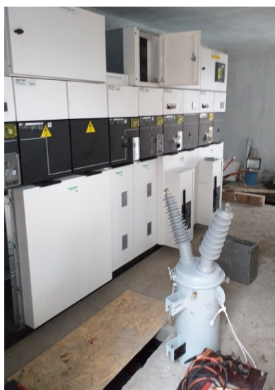
Slika 1. Izgled 10 kV novog razvodnog postrojenja u MHE i ispitnog transformatora 40 kV, 50 Hz
