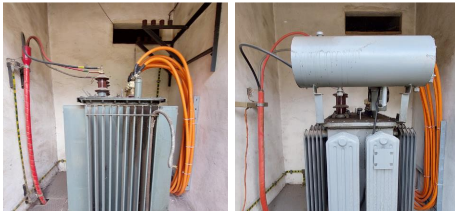
Слика 5. Просторије са трансформаторима T1 (лево) и T2 (десно)
