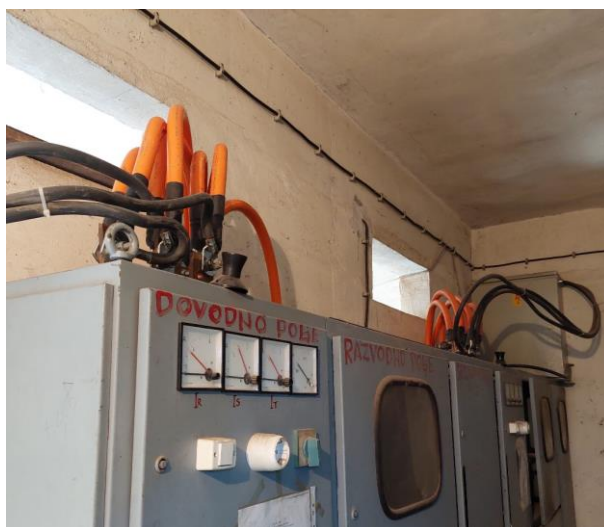
Слика 3. Просторија са разводима напонских нивоа 0,4 kV и 10 kV
