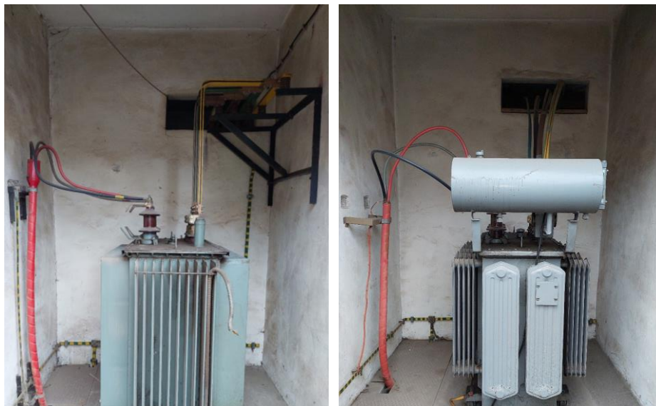
Слика 2. Просторије са трансформаторима Т1 (лево) и Т2 (десно)
