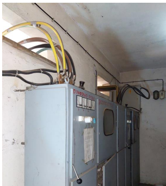
Слика 3. Просторија са разводима напонских нивоа 0,4 kV и 10 kV
